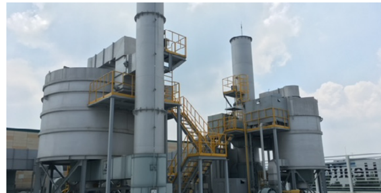
한독캠퍼스 RTO(축열연소산화설비) 설비
